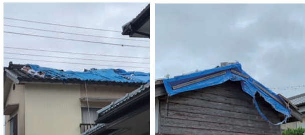
図8 ブルーシートが劣化している家屋
