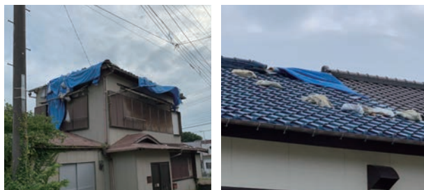
図9 土嚢の固定が外れた家屋
