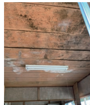
図4 屋根浸水した家屋
