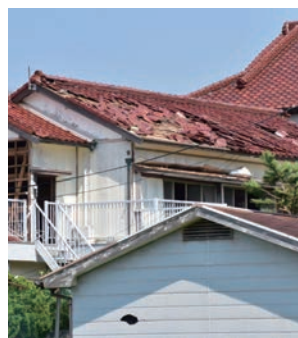
図3 一部分の瓦が飛散した家屋
